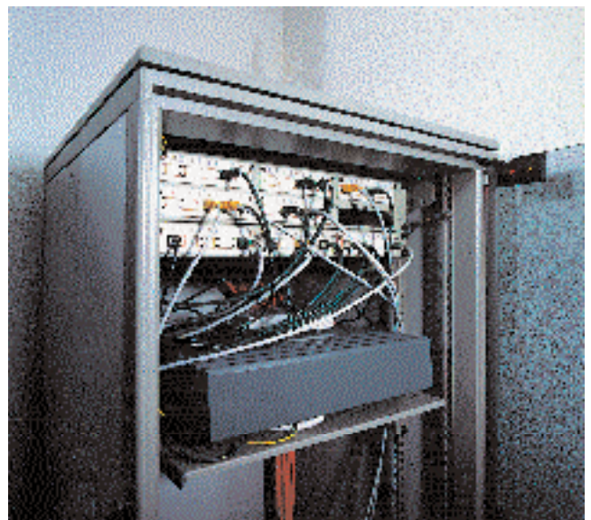
Abb. 7 Verteilerkasten, auch Rack genannt, des Ascotel bcs 4 in der Praxis von Dr. P. Portmann.
